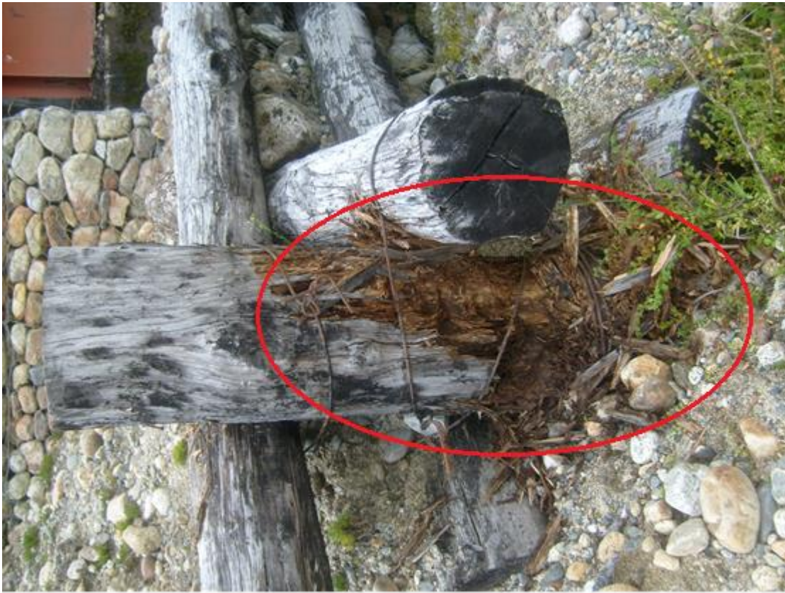
Estribo de un puente conformado por una jaba de madera rellena con áridos, la cual está en franca descomposición por la acción de hongos xilófagos (digestores de madera) que actúan cuando no se ha preservado químicamente el material antes de exponerlo a la intemperie.
